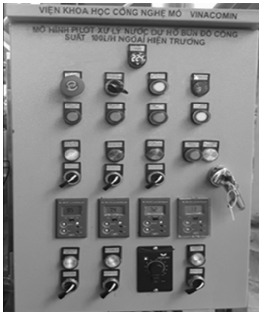
Hình 3. Tủ điện điều khiển
